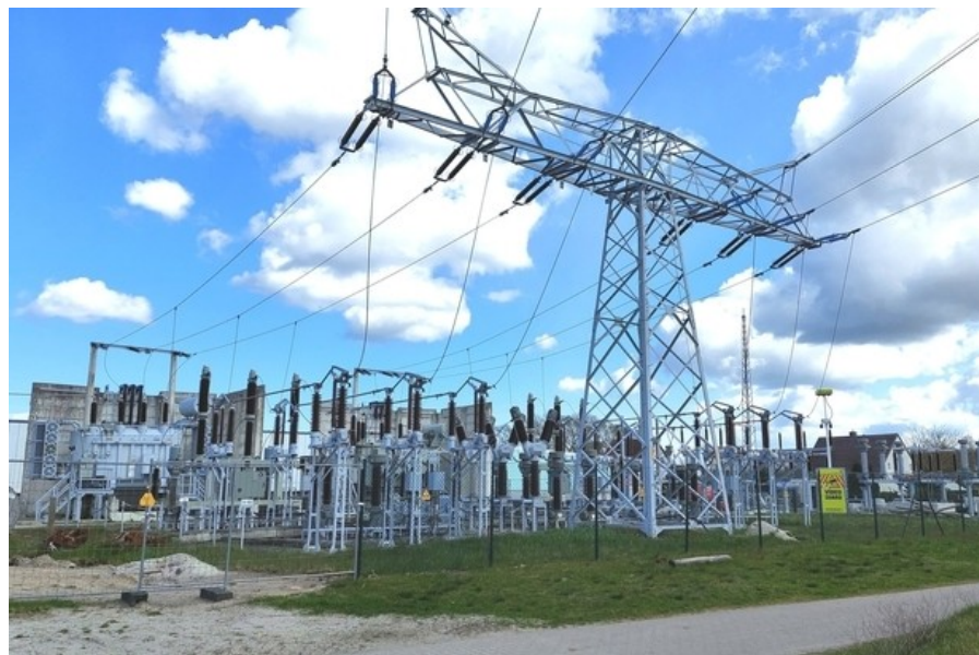
Bild 02: Umspannwerk auf der Insel Usedom 2023
