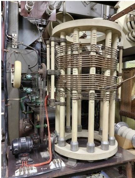
Bild 22: Variometer mit Keramik-Stützelementen im 40 kW-Großmesssender
